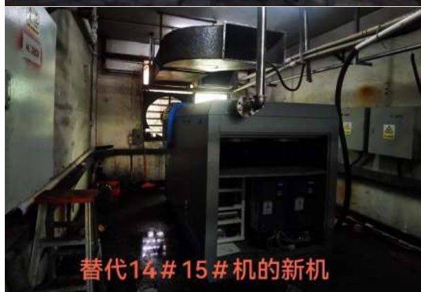
7 台永磁電機及變頻的空氣壓縮機
